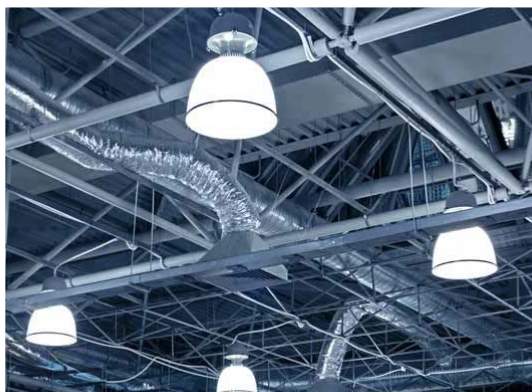
Luminarias y Reflectores
